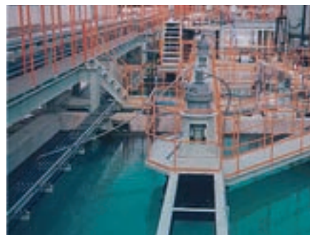
廃水処理設備
