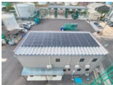
太陽電池パネル設置事例（弊社大野ケミカルセンター）
